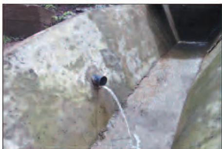
Photo 10 : Les eaux collectées se déversent dans le drain principal
