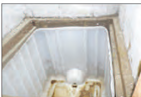
Photo 7 : Modèle 2, vue du cubitainer dans l'un des deux compartiments de la fosse
