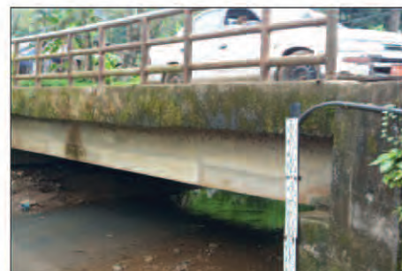
Photo 5 : Vue d'une station limnimétrique et du câble de connexion du module immergé du capteur de pression à l'unité centrale installée sur la berge
