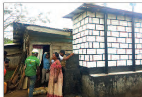
Photo 15 : Modèles 1 et 2, vue arrière de la latrine et des tuyaux de ventilation
