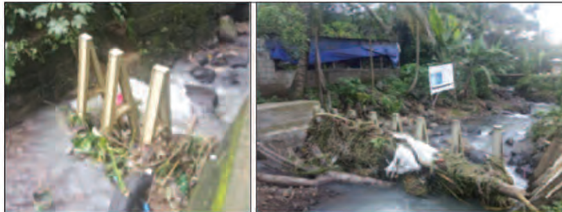
Photos 1a et 1b : Pièges à embâcles encombrés nécessitant une intervention
