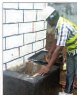
Photo 14 : Modèles 1 et 2, vue du regard de collecte des urines et des eaux usées
