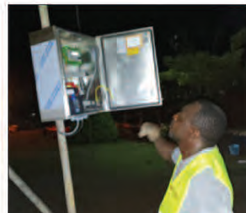
Photo 3 : Vue du coffret du pluviographe
