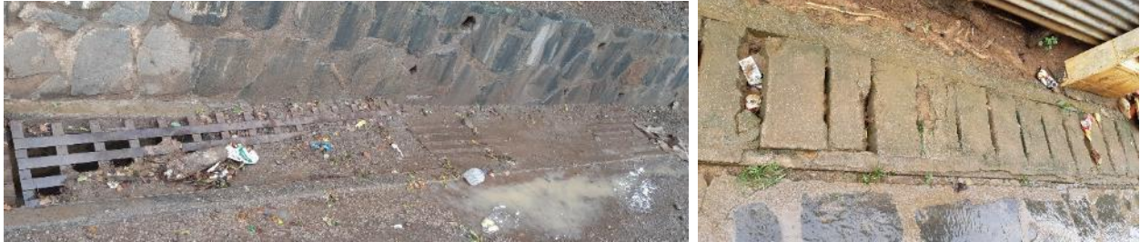
Photos des caniveaux à couverture en grillage d'acier galvanisé (à gauche) et couverture béton (à droite) colmatés par la boue et les déchets à Hamouro
