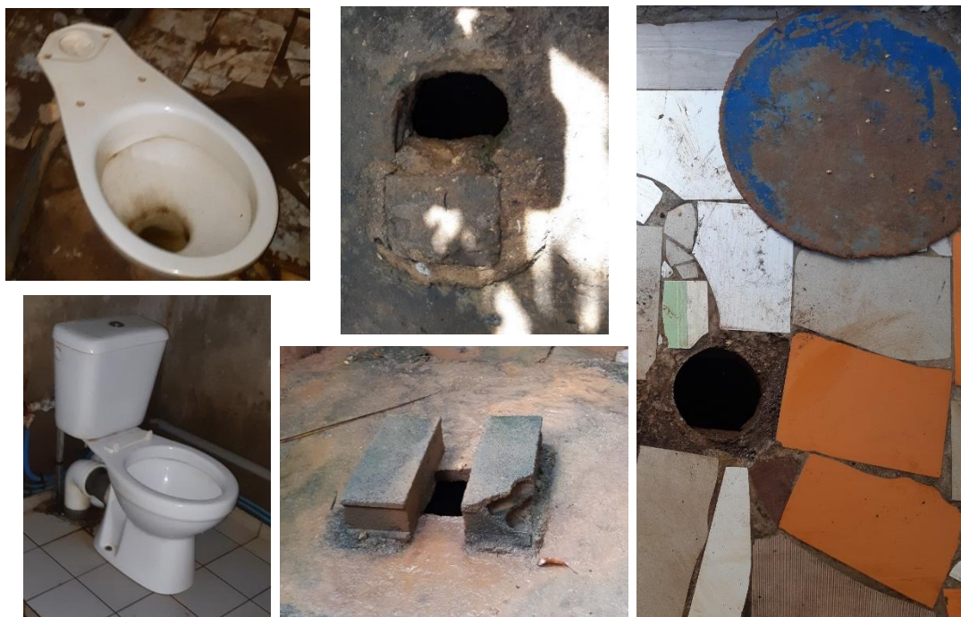
Divers types de toilettes et de dalles
