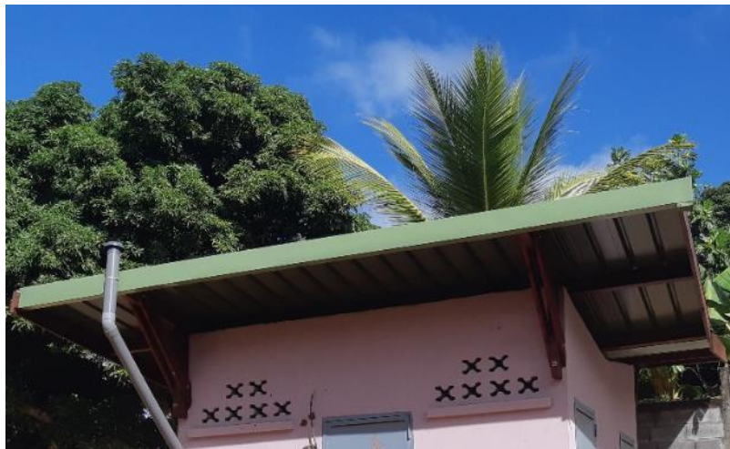
Photo des aérations du bloc sanitaire
