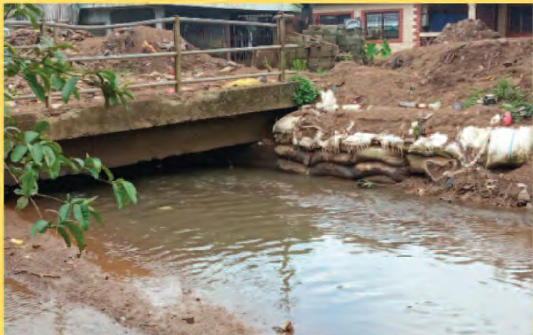
Vue des sacs de terre impactés après de fortes pluies, sans être emportés par l'inondation
