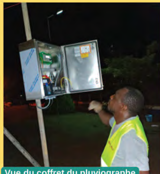
Vue du coffret du pluviographe
