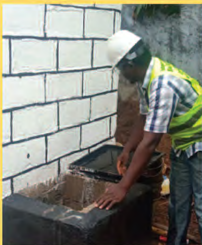
Modèles 1 et 2 : vue du regard de collecte des urines et des eaux usées
