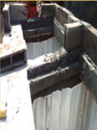
Vue intérieur des fosses des cabines 1 et 2
